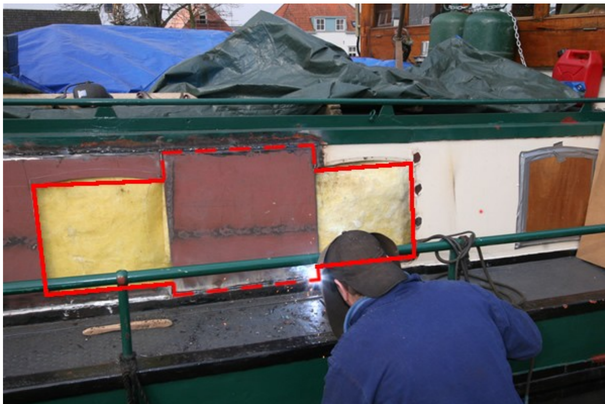
- - - Mit der Trennscheibe herausgeschnittenes Stahlstück ___ Durch diese Öffnung passte die Duschwanne problemlos
